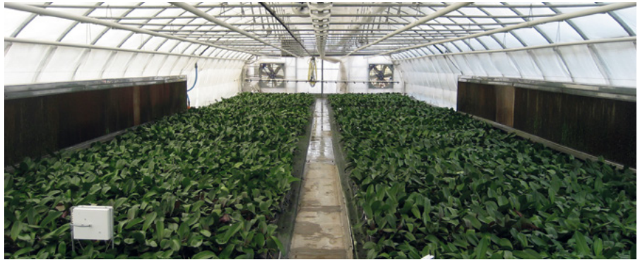
Sistema di ventole e pannelli dentro una serra bassa
