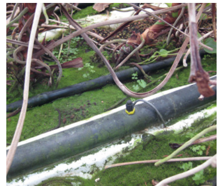
Condotti con ugelli a pioggia
